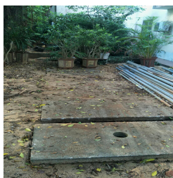
地埋式污水处理站
