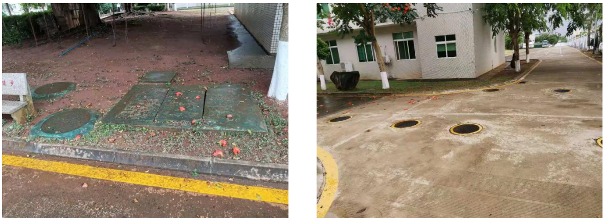
图 2-7 项目化粪池及污水下水道
