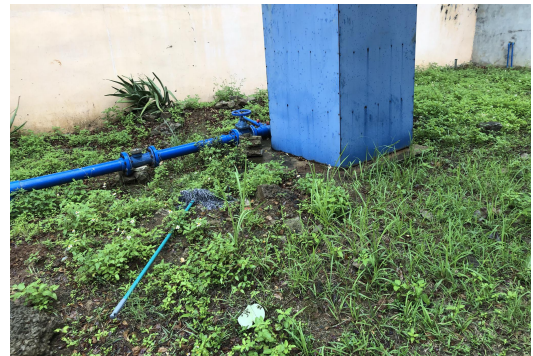
地埋式水泵 E110.438971693°，N19.967862301°
